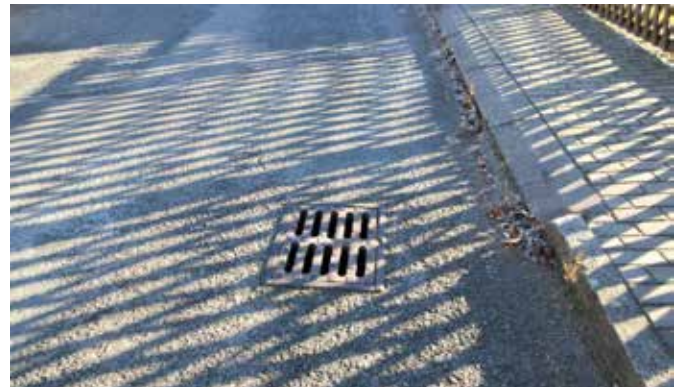
Tohle je nebezpečné.
