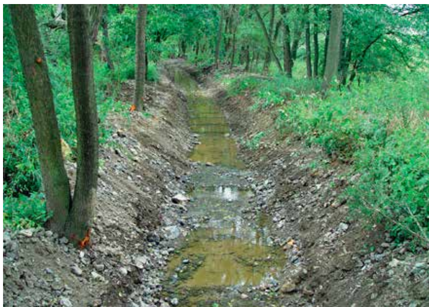
Příklad velmi necitlivé a zbytečné úpravy toku s výskytem raka kamenáče. Památná úprava Přešinského potoka v roce 2003 před odstraněním údajných povodňových škod (nahore) a po něm (dole). Foto David Fischer.
